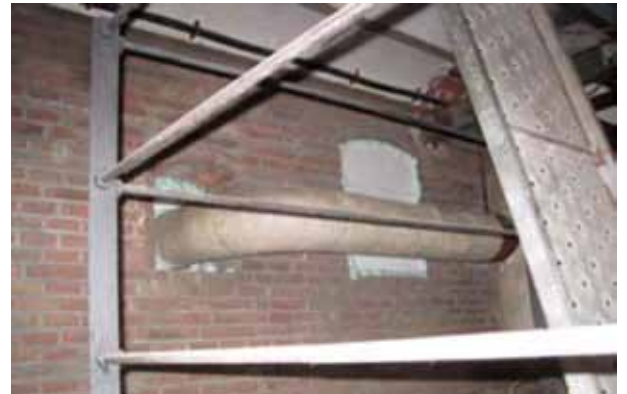
Figura 5. Identificación de posibles entradas de aire.
