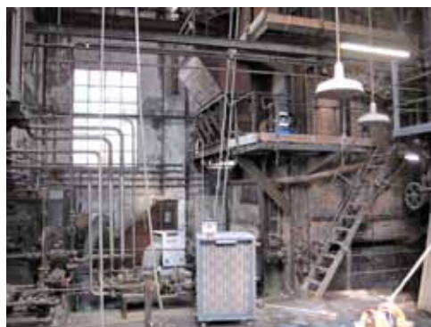
Figura 13. Líneas de vida, barandillas, y otros medios auxiliares
